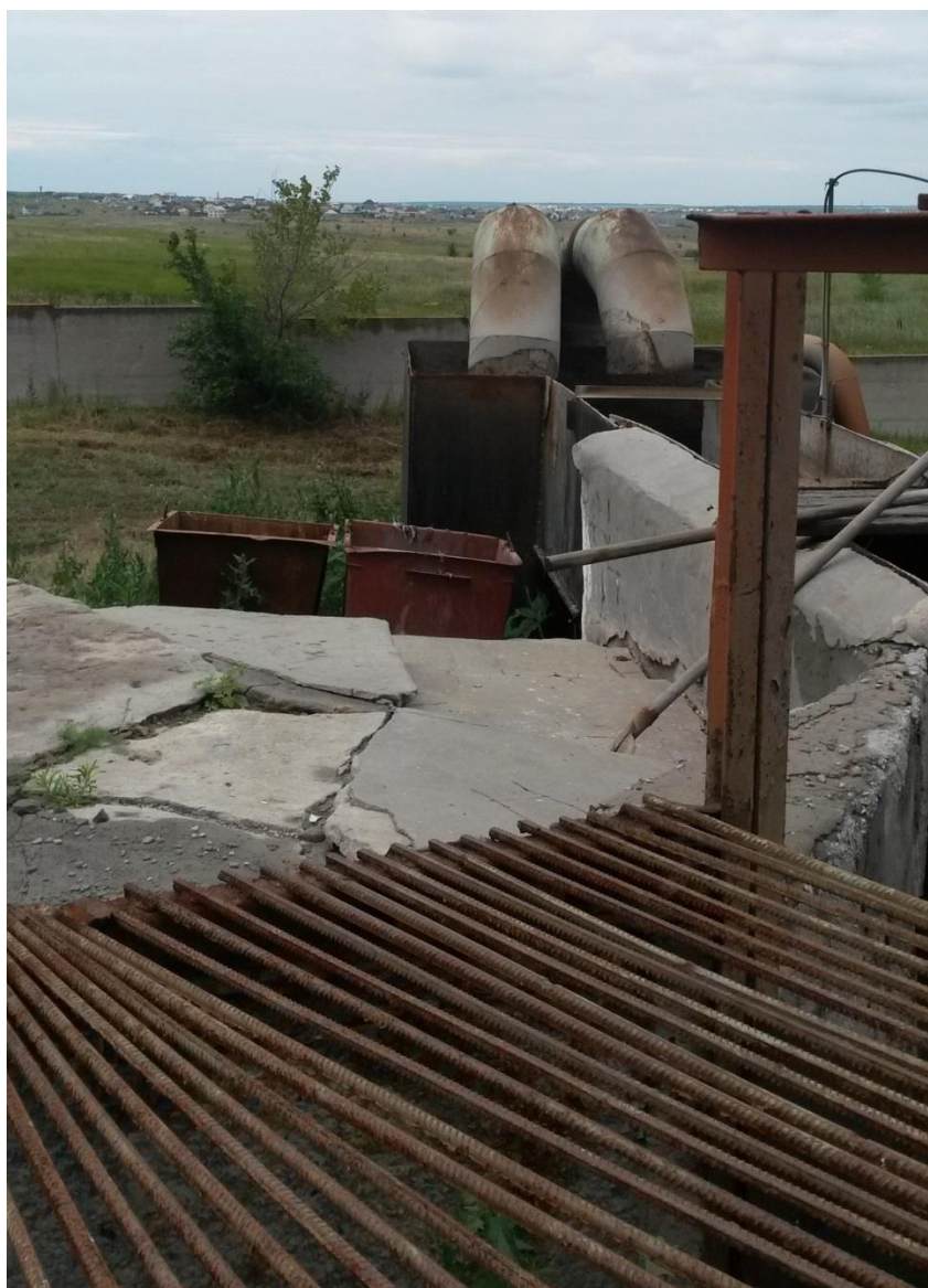
Рисунок 20 - Приемная камера канализационных очистных сооружений
